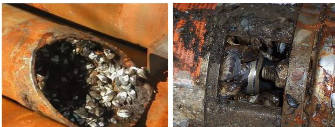
Рисунок 6.2 – Заращение водопроводной трубы и разрушение насоса дрейссеной
